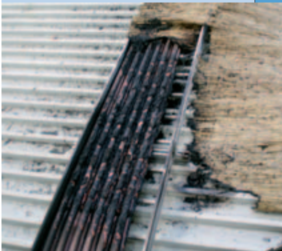
2. 9. ▲ Brand einer Hochspannungskabeltrasse in der Energieanlage neben dem WSK-Kamin.
