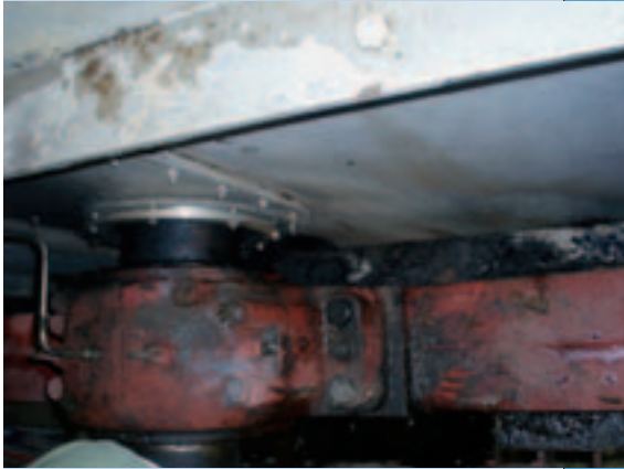
15. 8. ▲ Lagerbrand beim Scheibenfilter II in der TMP-Anlage, Löscharbeiten.
